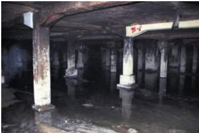
FIGURA 16 – PROBLEMAS ESTRUTURAIS DAS VIAS E DO VIADUTO CONSTRUÍDOS SOBRE O RIO CHEONGGYECHEON
